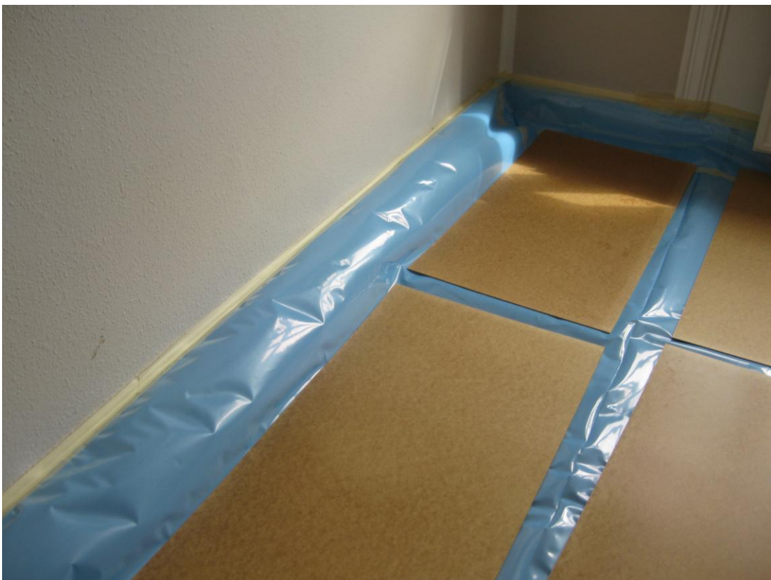
Foto 4: Ved 50 Pa undertryk løfter dampspærren sig langs paneler
