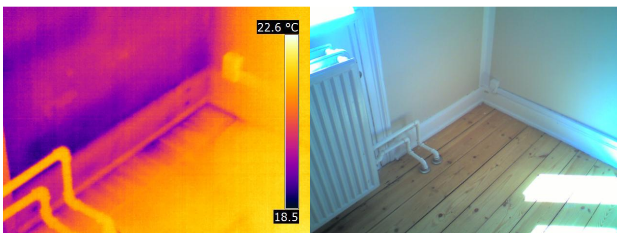
Termografi 18 - IR10076 Tydelige kolde luftstrømme langs fodpanel ud vinkelret på gulvbrædder fra facadens bagmur i stue – Th i billedet varm massiv murværksvæg - Gulv er uden gulvpap/filt og dampspærre
