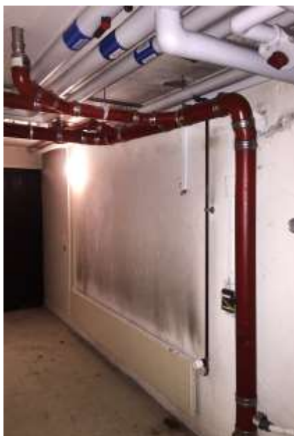
Figur 2.2. Total udskiftning af faldstamme i støbejern
