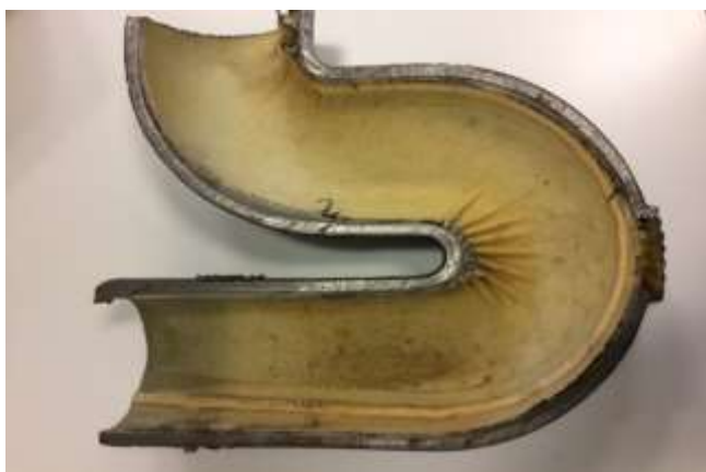
Figur 7.6. Reovering af vandlåse med strømpeforinger kan medføre folder i bøjningerne
