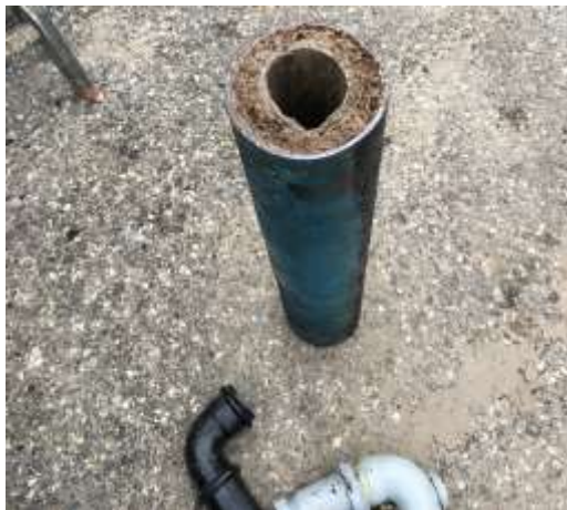
Figur 6.4. Faldstamme med faste aflejringer og fedt/rust mm.
