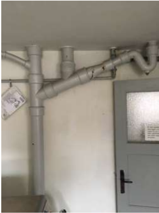
Figur 6.3. Synlige ledninger i kælder kan udskiftes i stedet for at blive renoverede
