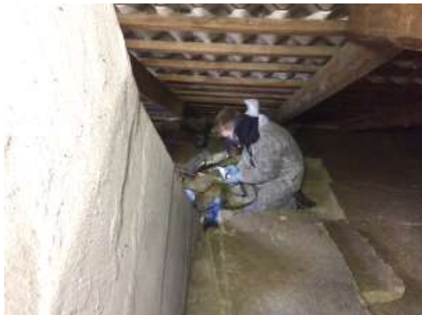
Figur 7.5. Faldstammer kan være vanskelige at komme til. I dette tilfælde var det nødvendigt at anbringe udstyret oppe på et trangt loft
