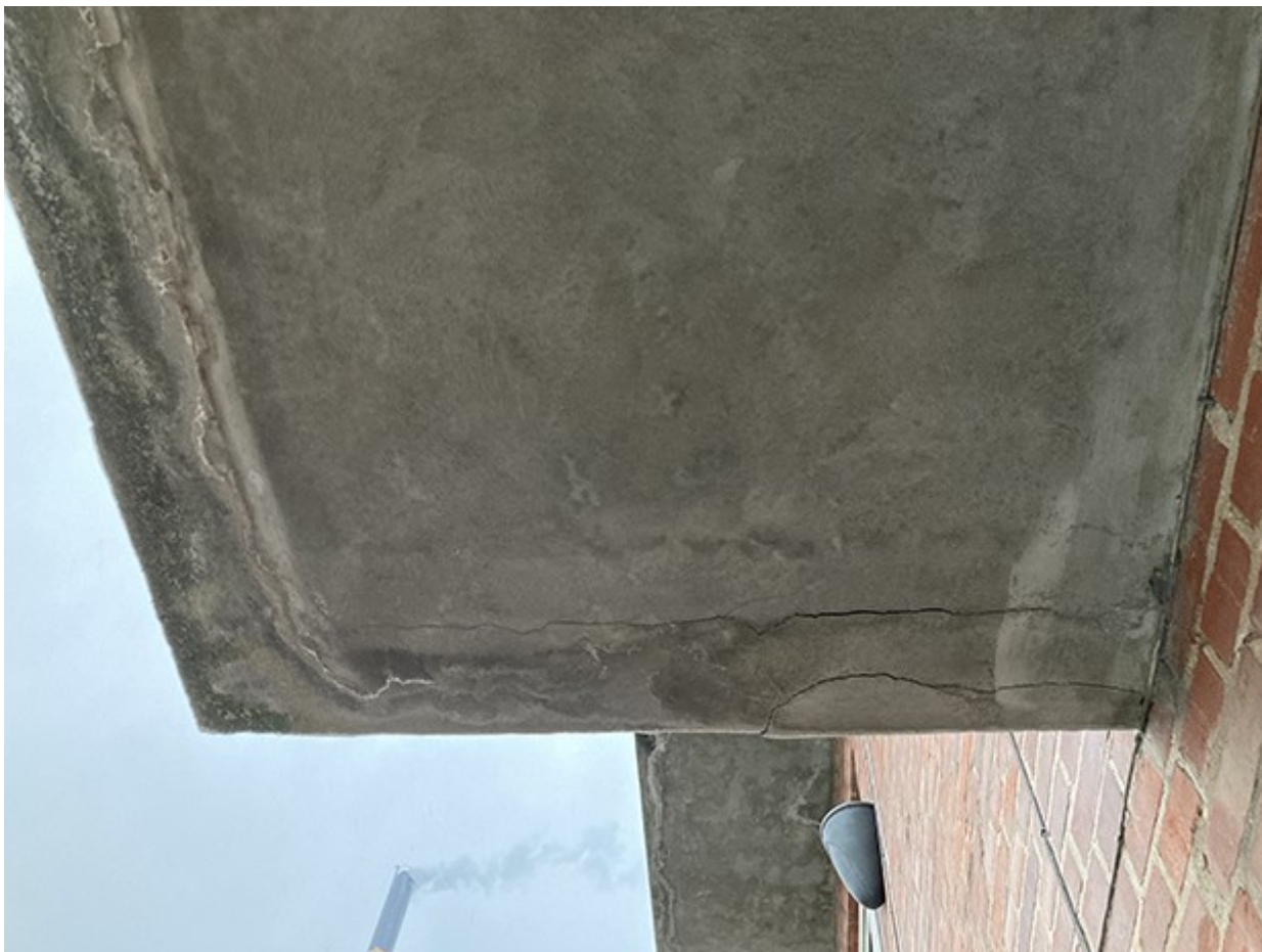
Foto 5-9. Revner i undersiden af altanpladen lokaliseret i området umiddelbart under/langs udliggerjer- net og fugtskjolder med hvide udfældninger langs kanten.
