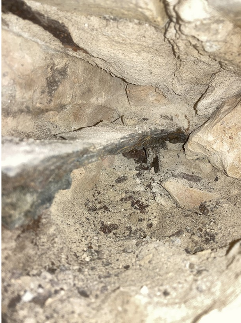
Foto 6-4. Udliggerjern, hvor det ses at kroppen af profilet er tæret helt væk. Overflagen er desuden ligeledes med betydelig tværsnitsreduktion. På altaner hvor udliggerjernenes tilstand er som dette, vil bærevnen være reduceret betydeligt.
