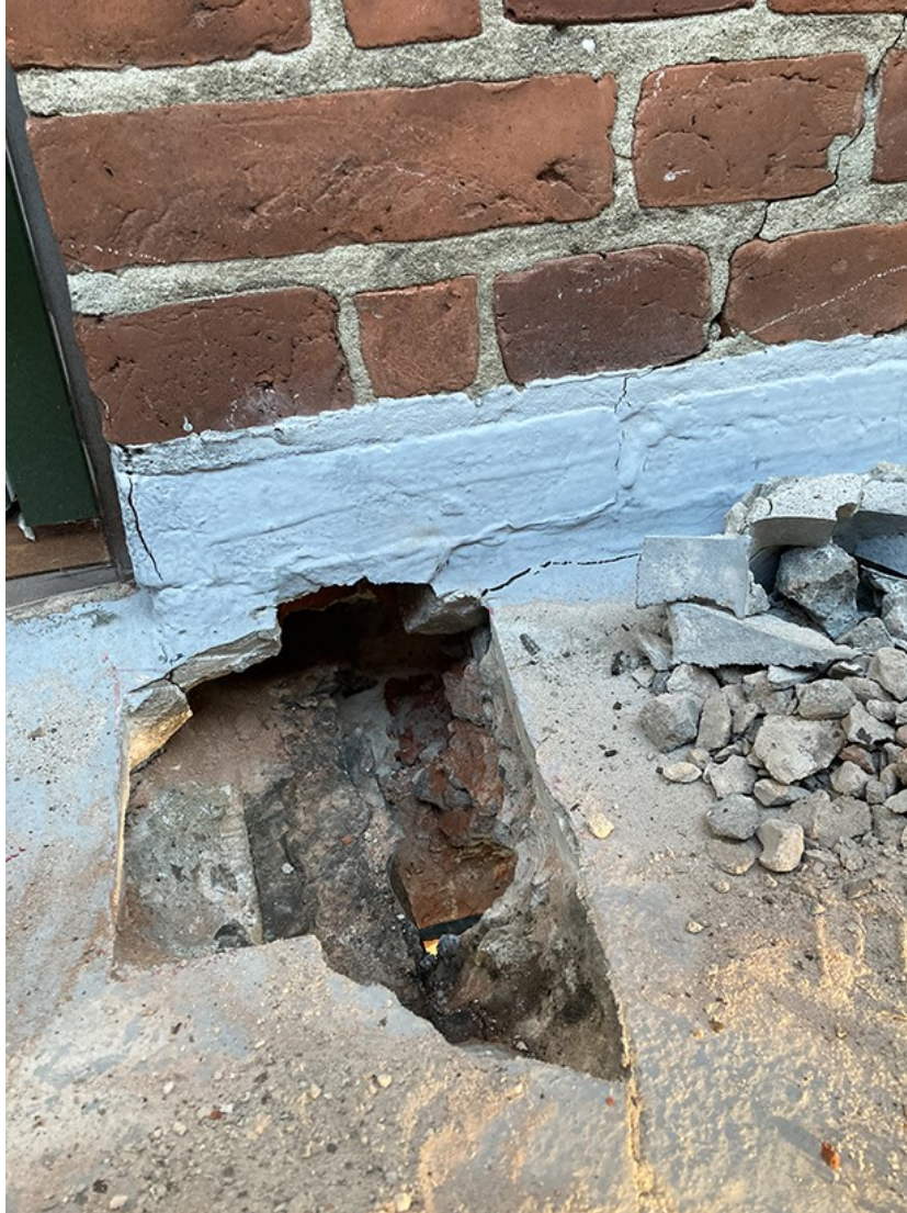
Foto 6-1. Udliggerjern, hvor det ses at overflangen er med tværsnitsreduktion i den højre side. Oven på overflangen ses rustflager (korrosionsprodukter), ligesom der ses revner i murværket over udliggerjernet.
