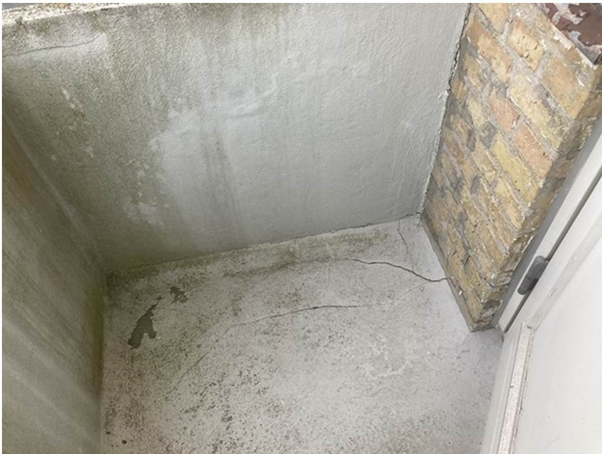
Foto 5-1. Revner i pudslag på oversiden lokaliseret umiddelbart over udliggerjernet. Vær opmærksom på, om der også kan registreres en hul/skruk lyd i området over udliggerjernet pga. manglende vedhæftningen mellem betonen og pudslaget eller betonen og udliggerjernet.
