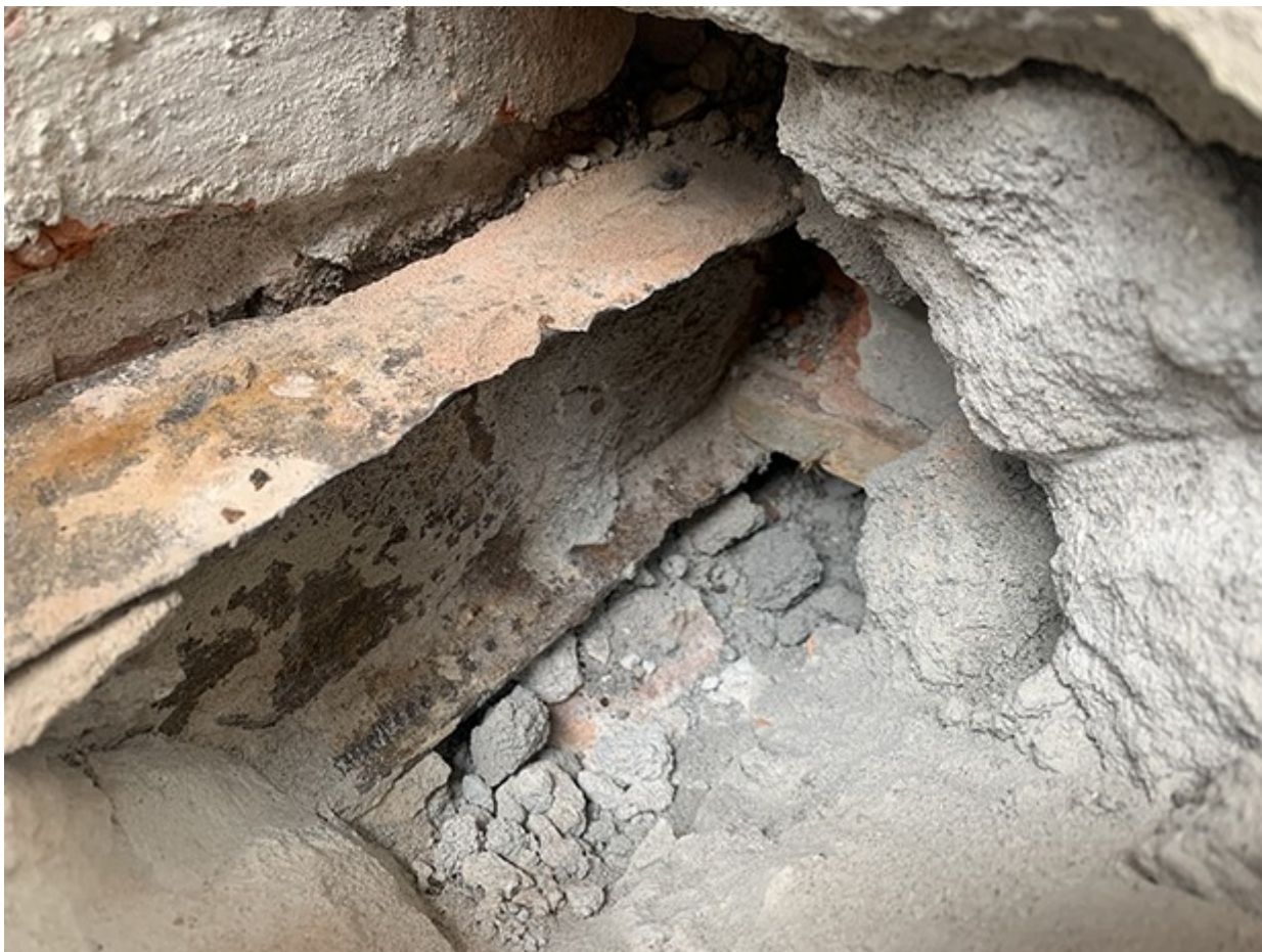
Foto 6-8. Udliggerjern, hvor det ses, at overflangen er med tværsnitsreduktion i begge sider.
