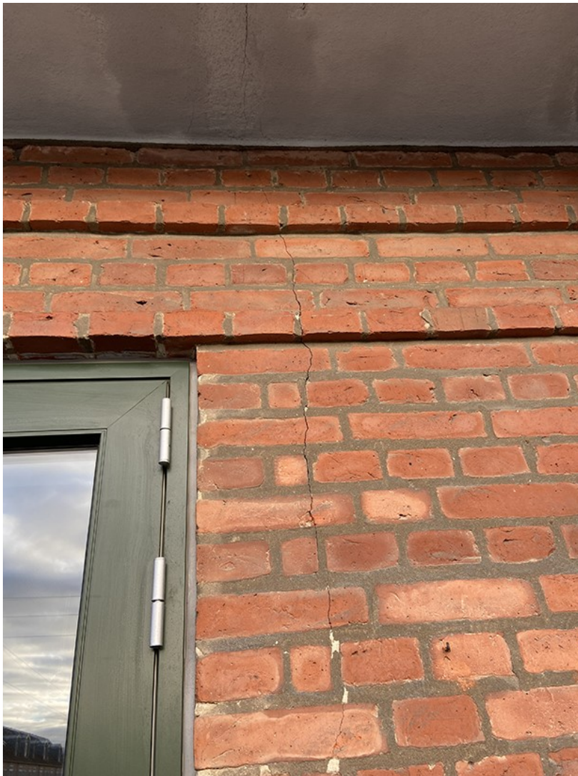
Foto 5-4. Lodret orienteret revne i murværket lokaliseret umiddelbart under udliggerjernet.
