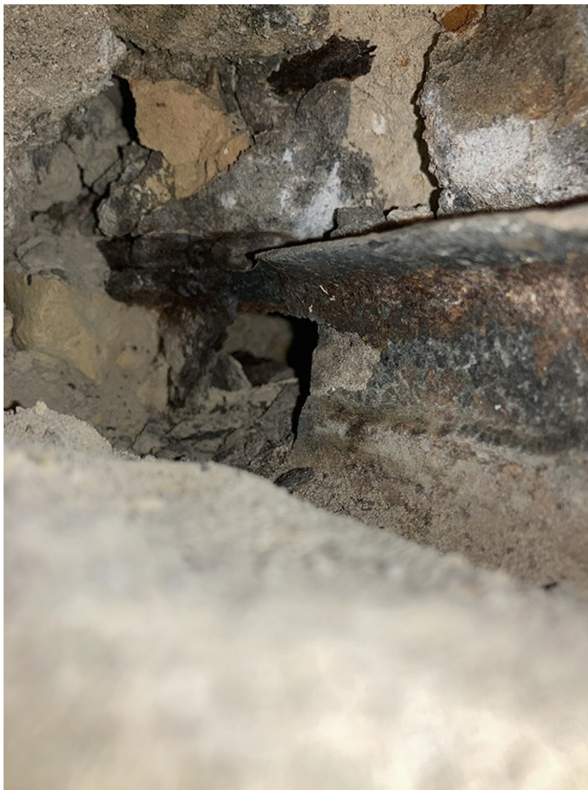
Foto 6-3. Udliggerjern, hvor det ses, at kroppen af profilet er tæret helt væk (hul i midten). Overflangen er ligeledes med betydelig tværsnitsreduktion og tæring. På altaner hvor udliggerjernenes tilstand er som dette, vil bærevnen være reduceret betydeligt.
