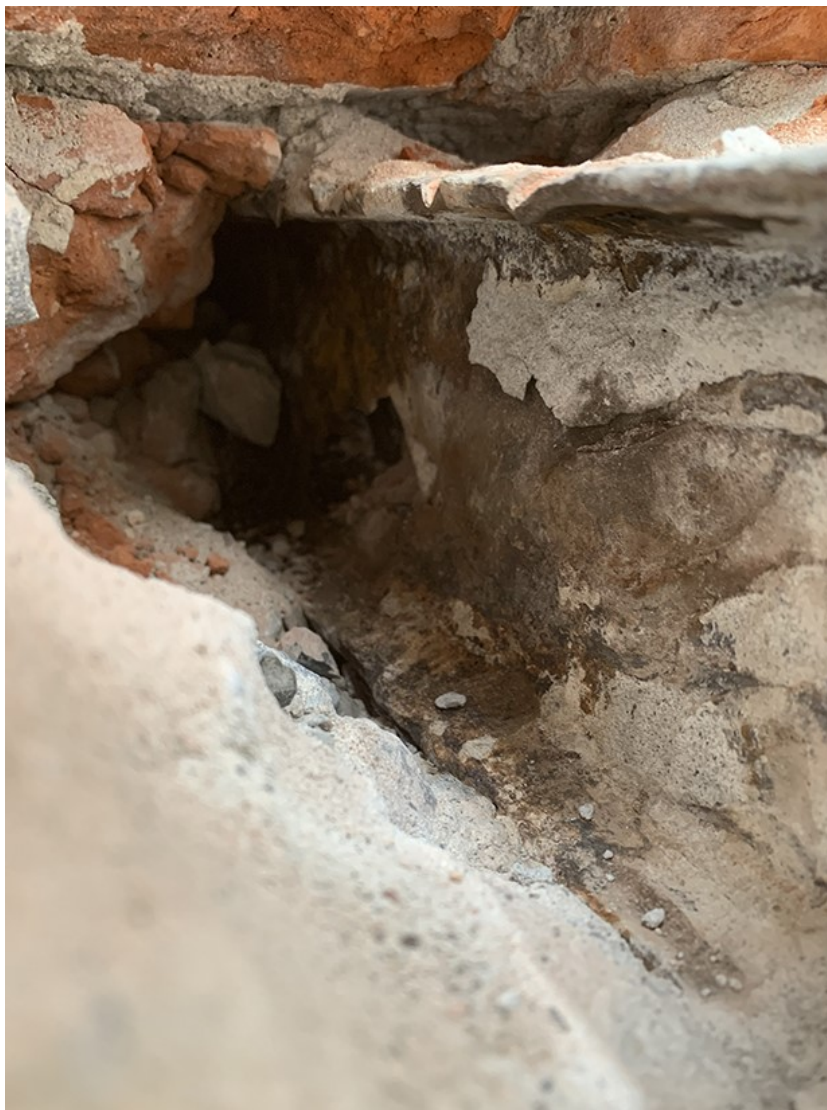
Foto 6-6. Udliggerjern, hvor det ses, at kroppen af profilet er tæret igennem ca. midt på kroppen (hul i midten).
