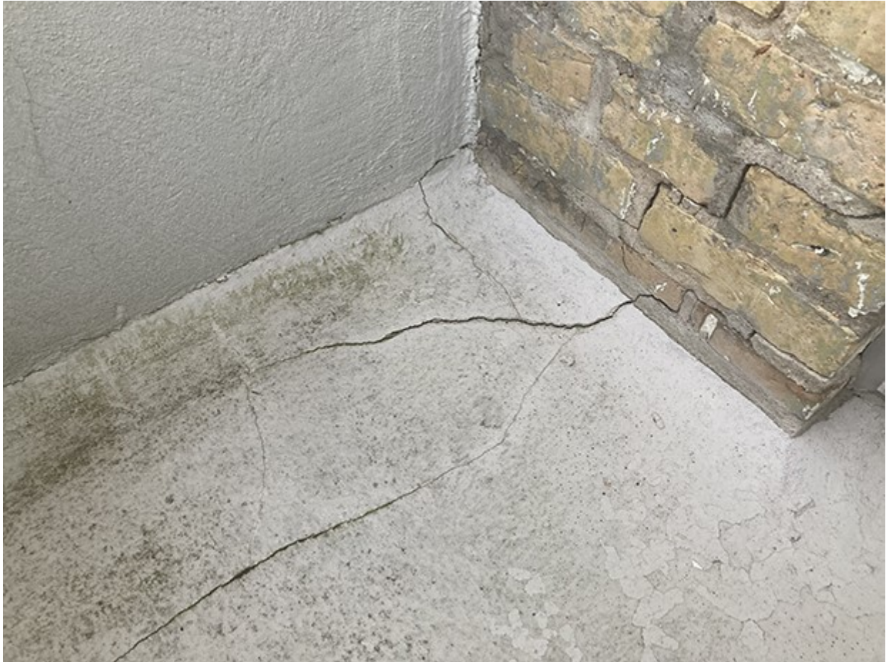
Foto 5-2. (samme altan som forrige foto – nærbillede) Revner i pudslag på oversiden lokaliseret umiddelbart over udliggerjernet. Derudover ses revner i murværket.
