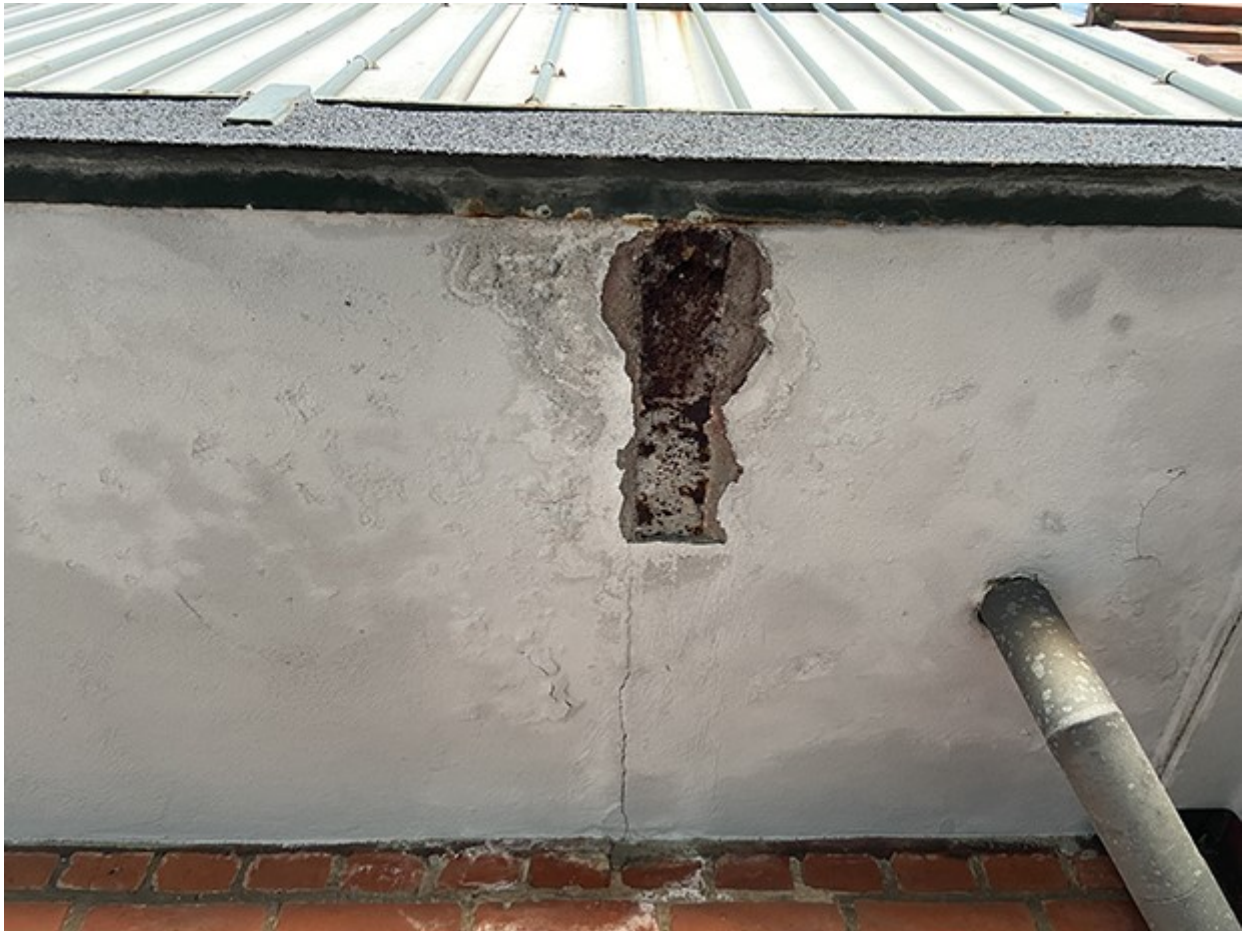
Foto 5-11. Afskalning af pudslag/overfladen under udliggerjernet på undersiden af altanplade. På murværket omkring udliggerjernet ses desuden hvide udfældninger på overfladen.
