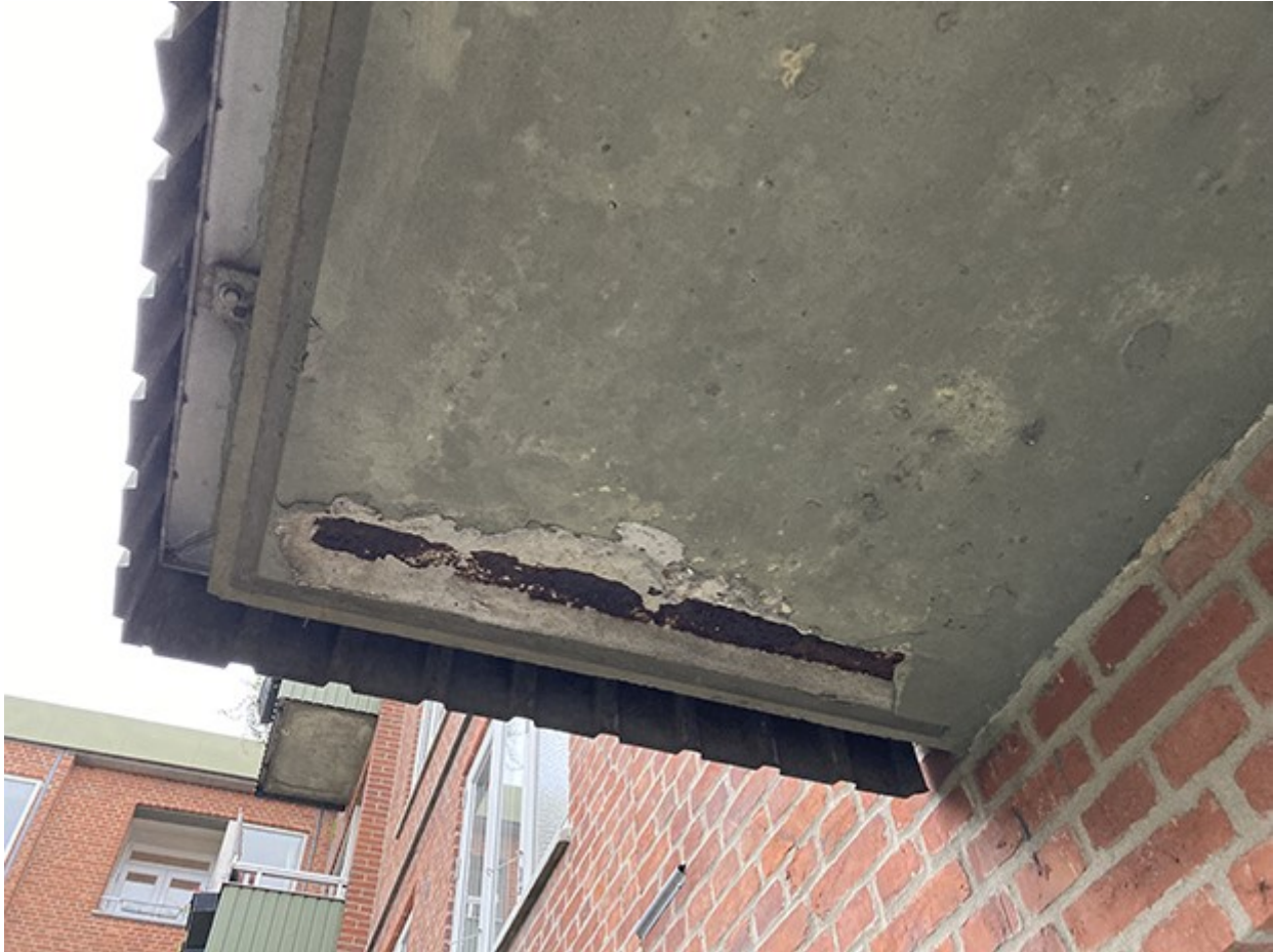
Foto 5-10. Afskalning af pudslag/overfladen under udliggerjernet på undersiden af altanplade.
