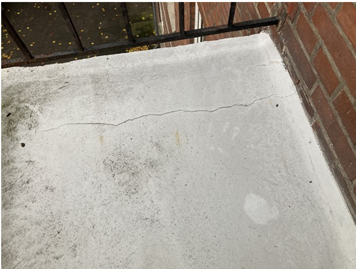
Foto 5-3. Revne i pudslag på oversiden lokaliseret umiddelbart langs udliggerjernet. Vær opmærksom på, om der også kan registreres en hul/skruk lyd i området over udliggerjernet pga. manglende vedhæftningen mellem betonen og pudslaget eller betonen og udliggerjernet.
