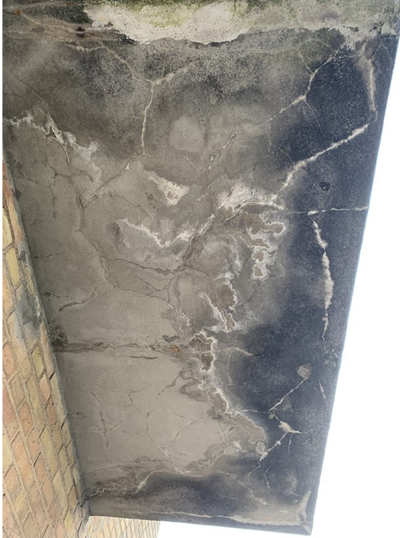
Foto 5-7. Omfattende revner med hvide udfældninger på underside af altanplade og fugtskjolder/mørkfarvning langs kanten. Ved revne lokaliseret i området umiddelbart under udliggerjernet ses desuden røde/brune udfældninger. I dette tilfælde er betonen tilsyneladende udtjent.
