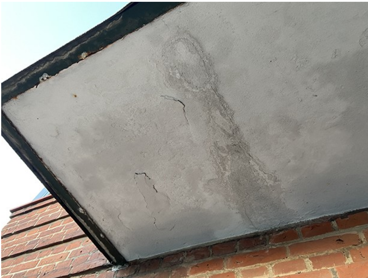
Foto 5-6. Revner i undersiden af altanpladen lokaliseret i området umiddelbart under/langs udliggerjernet. Desuden ses begyndende afskalninger/revner i selve altanpladen.
