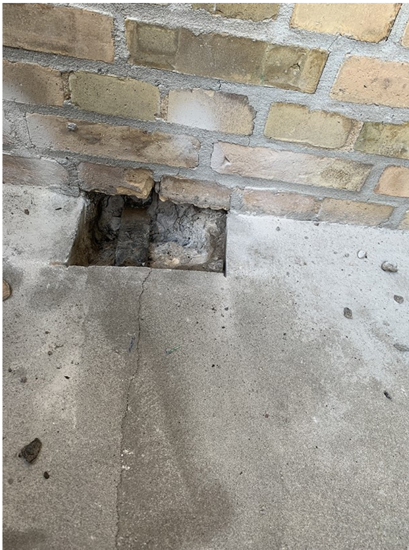
Foto 6-2. Udliggerjern, hvor der ses korrosion på oversiden af overflangen. Der ses en revne i pudslaget, som er lokaliseret over udliggerjernet.
