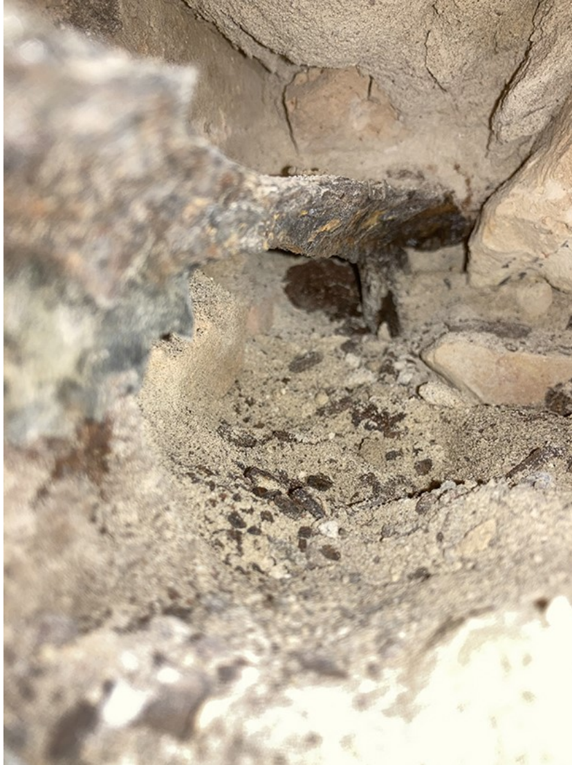
Foto 6-5. (samme udliggerjern som på forrige foto). Overflangens indsnævring ses og kroppen er tæret helt væk.
