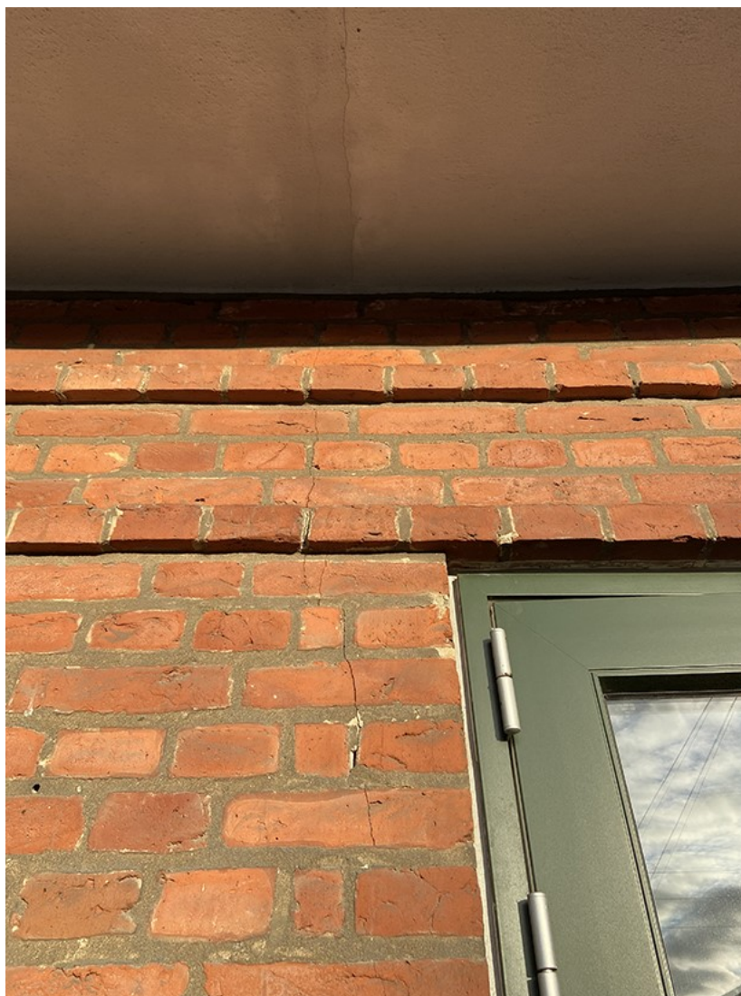
Foto 5-5. Lodret orienteret revne i murværket lokaliseret umiddelbart under udliggerjernet.
