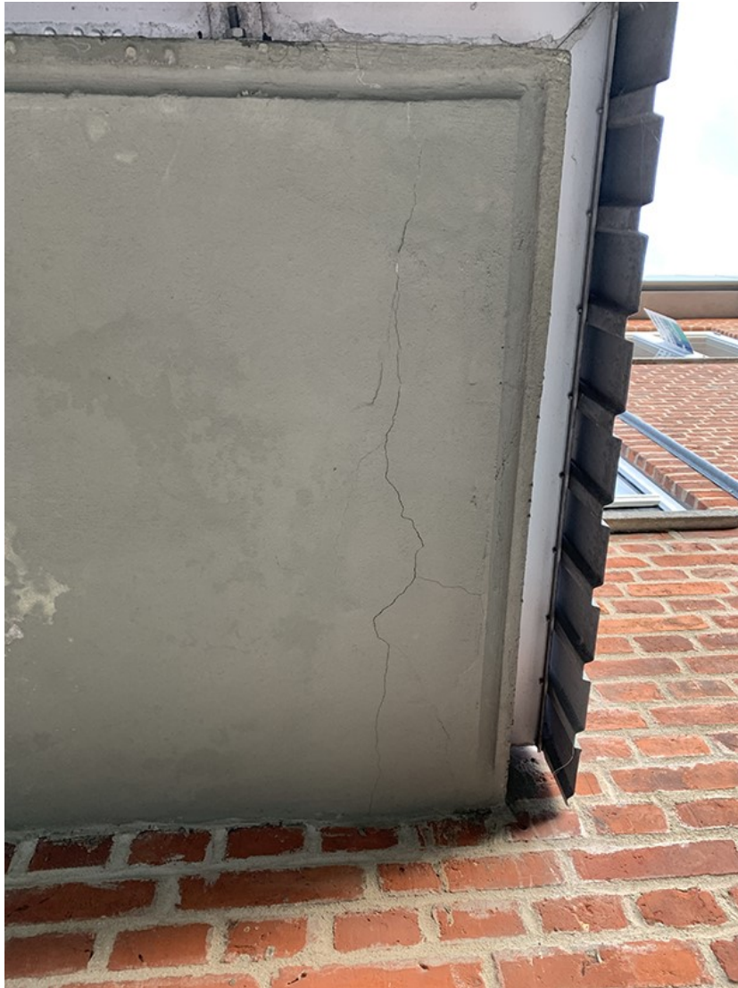
Foto 5-8. Revner i undersiden af altanpladen lokaliseret i området umiddelbart under/langs udliggerjernet.
