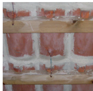
På traditionelle tegltage er det ikke alle tagsten, der er bundet fast.
