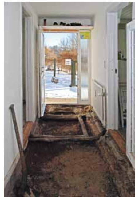
Det udgravede gangareal som muliggør overblik over sætningsskaden.
