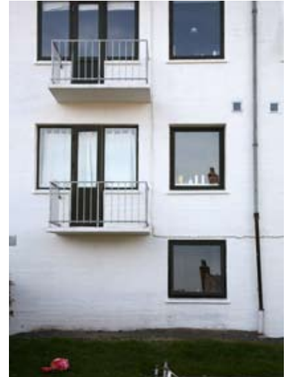
Tykke altangelændere spolerer facadens raffinerede udtryk. Altandøre med fyldninger og brede rammer forsimples facaden. Lodrette balustre er fremmede for funkisstilen.
