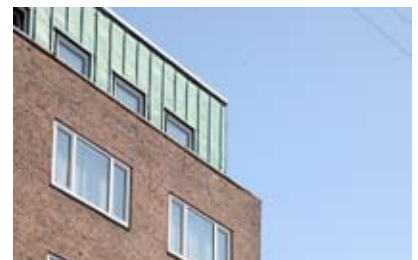
Overgangen mellem penthouse og facademurværk fremstår skarp.
