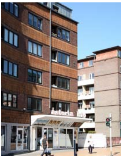
Det ændrede tagnedløb spolerer facadens vandrette udtryk.
