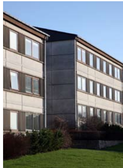
Et stringent elementbyggeri, hvor betonelementerne har fået patina. En malerbehandling af træværket vil optimere facadeudtrykket.
