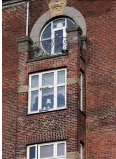
Ingerslevsgade, København (1908 af J.P. Rasmussen). En tilsvarende facade, hvor karnap og altan er bevaret.
