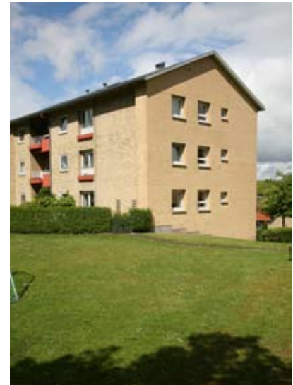
Massive gavlmurer kræver efterisolering. Gavl- mur skalmuret med samme stentype som den oprindelige.
