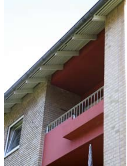
Synlige spærender og udhængsbrædder, blankt murværk, malerbehandlet cementbrystning og hvidmalet stålrækværk er eksempler på stilartens glæde ved håndværk, enkelhed og rustik stoflighed.
